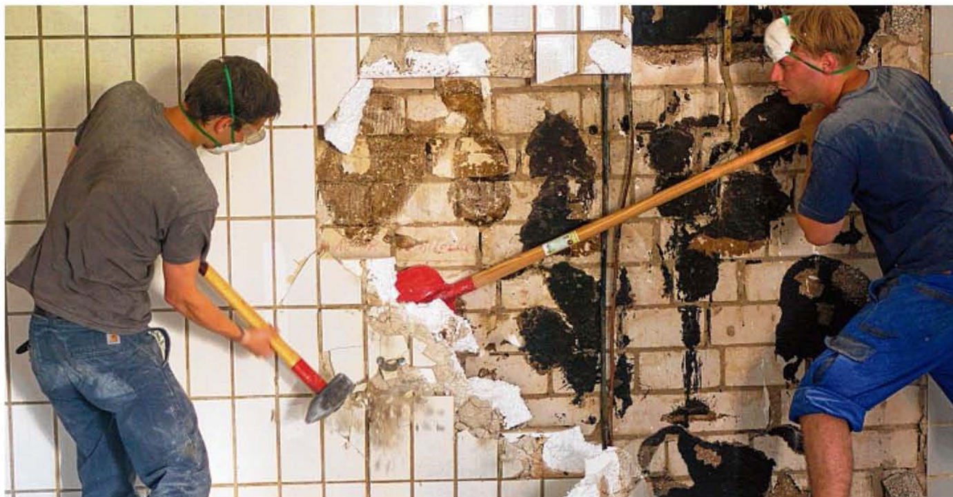
Und wieder bricht ein Stück aus der Wand: Der ehemalige Kühlraum des Edeka-Marktes wird komplett umgebaut.
